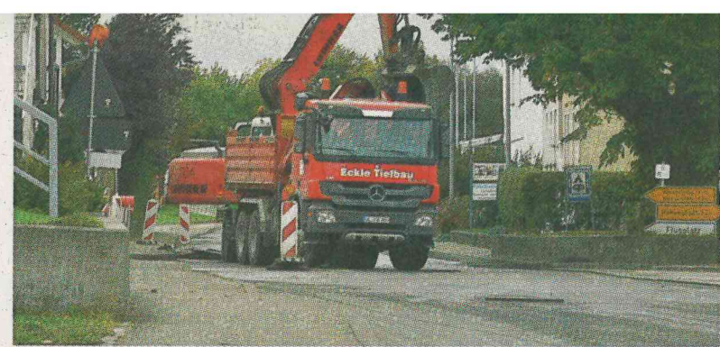
Auch für die Anlieger sind die Westerheimer Straße und die Olgastraße gesperrt. Umfangreiche Asphaltarbeiten stehen an. FOTO: HANSJÖRG STEIDLE
